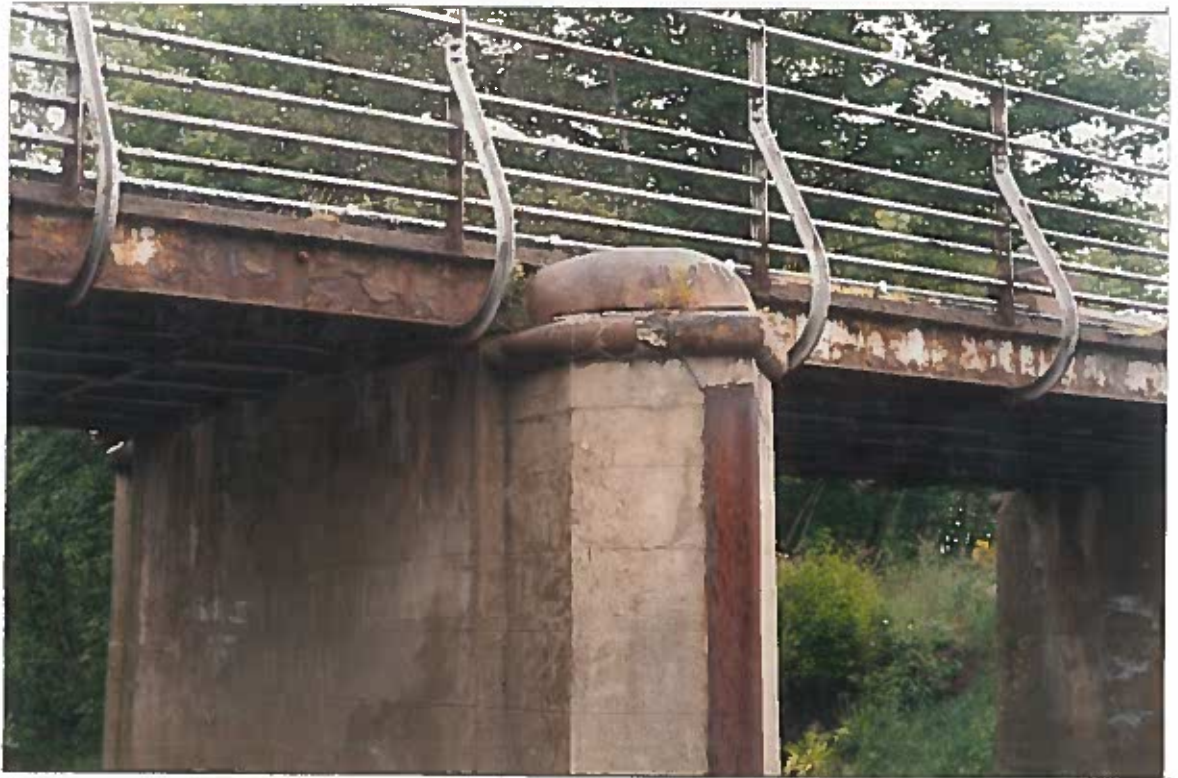
CORRODED EDGE BEAM
